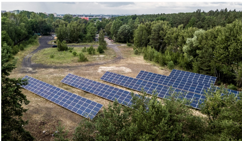
Fot. 2. Fotowoltaika na terenie Ciepłowni Rejonowej Dąbska Źródło: SEC
